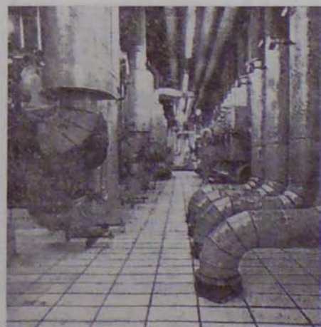
A Univac 494 real-time rendszer zavarmentes üzemeltetésére számos biztonsági berendezést készítettek, valamint gondoskodtak a tökéletes légkondicionálásról. A képen a számítógéppont alagsorát láthatjuk a légkondicionáló berendezéssel.
