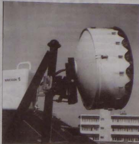
Az Ericsson EDACS rádióhírközlő antennája az ORFK bevetésirányítási rendszerének június 9-e óta üzemelő mintá- és oktatóközpontjában, a III. kerületi rendőr-főkapitányság épületének tetején (Lásd cikkünket a 7. oldalon.)
