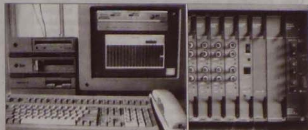
A Budapest Gyűrű vezérlő számítógépe és a végpontok közötti kapcsolatot szervező modul
