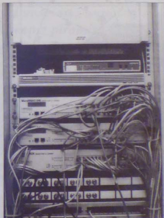
A Rolitron által telepített szintenkénti elosztó szerelőszerkező és strukturált kábelezési rendszer konfigurálhatóságát biztosító elosztópanelokkal és a szint számítógépeit ellátó aktív elemekkel
