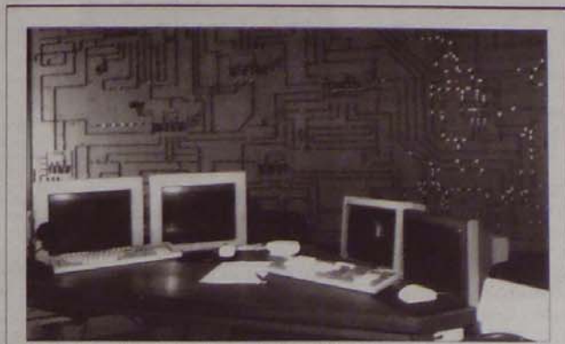
Képünkön a Tiszántúli Áramszolgáltató Rt. új üzemi irányító központja. Az irányítórendszerrel szóló beszámolókat a 3. oldalon olvashatják
