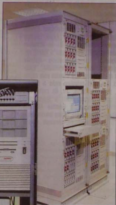
Működő SQL Server a dokumentumrendszert rendszer kiszolgálógepein (4 darab ProLiant 6000)
