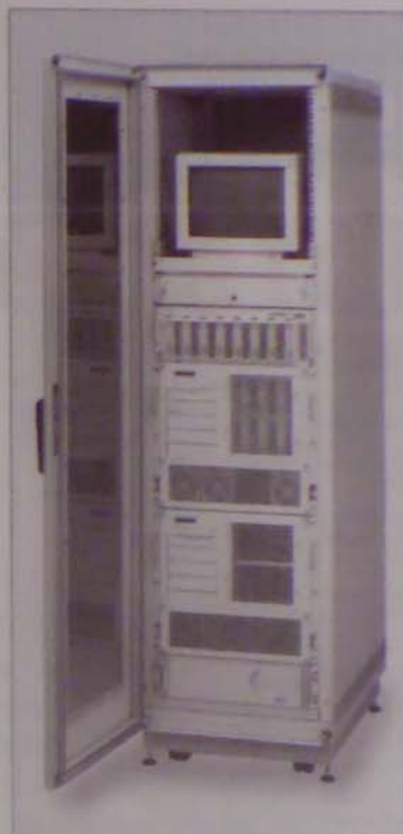
Szekrénybe épített Fujitsu kiszolgáló
