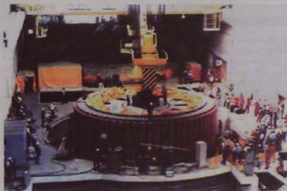
A Siemens szállította a San Franciscó-i erőmű berendezéseit (Fotó: A Siemens AG webes sajtóarchívuma)
