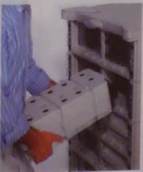
1. kép. Akkumulátormodul cseréje a Symmetrában
