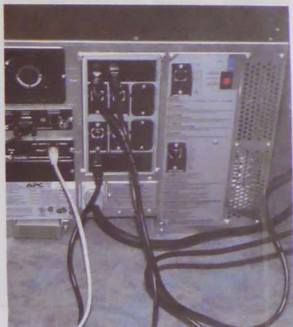
2. kép. Dugalj dugalj hátán
