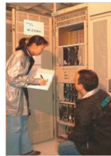
UMTS-hálózatépítés: nem csak a licencdíj horribilis
