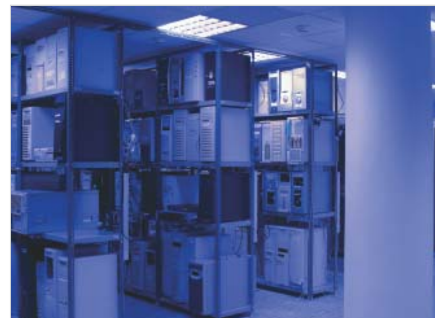
A co-location üzletág: az ügyfelek saját számítógépei a legnagyobb hazai szerverközpontban
