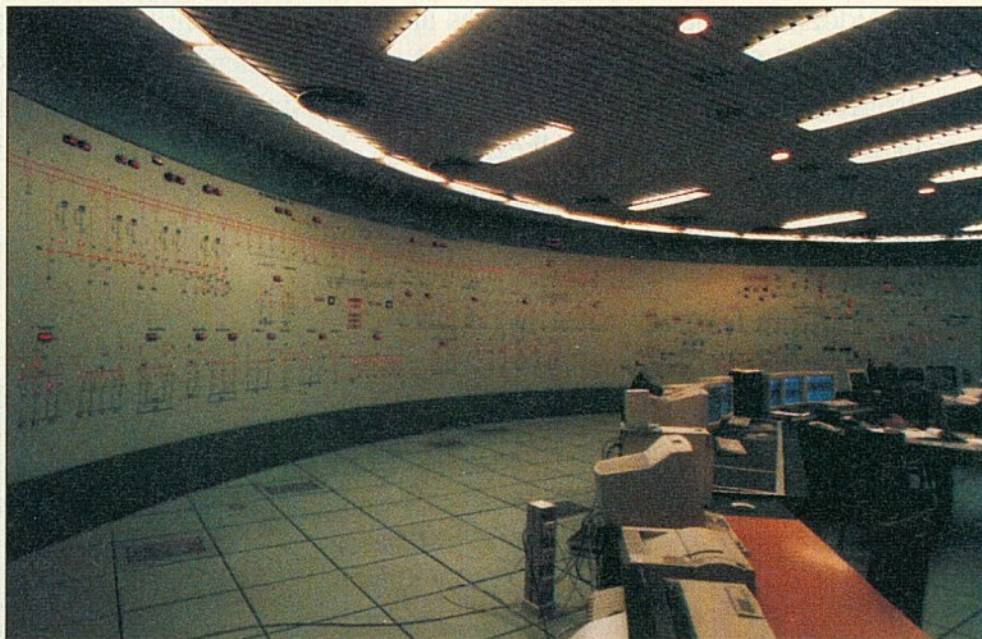
A repülőtér elektromos ellátását irányító terem
