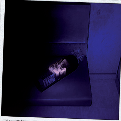
Elő az UV lámpát! Ohohó, egy kéznyom. Megállapíthatjuk, hogy ezt a tűzoltókészüléket valaki actually megfogta. A feszültség a tetőfokára hág...
